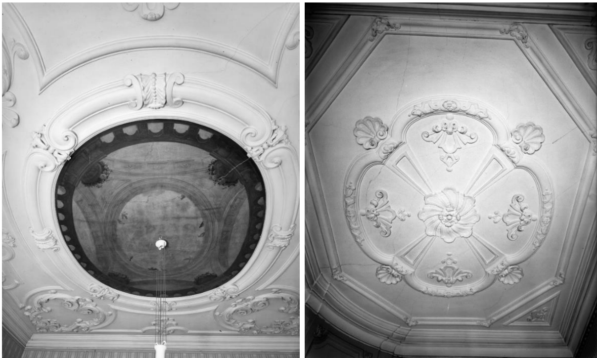
21, 22. Stucplafonds op de verdieping van de zijvleugel aan de Heulstraat. RCE, Amersfoort, fotocollectie, obj.nr. 12.025 (links), obj.nr. 17.685 (rechts). Foto uit 1937.
