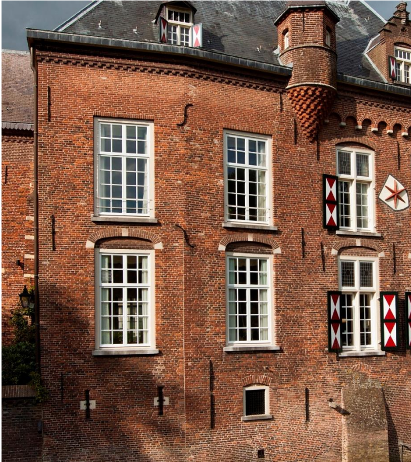
2.26. Detail van de zuidgevel van Maurick. M. Bolsius (2014). Foto vanuit het zuidwesten genomen.
