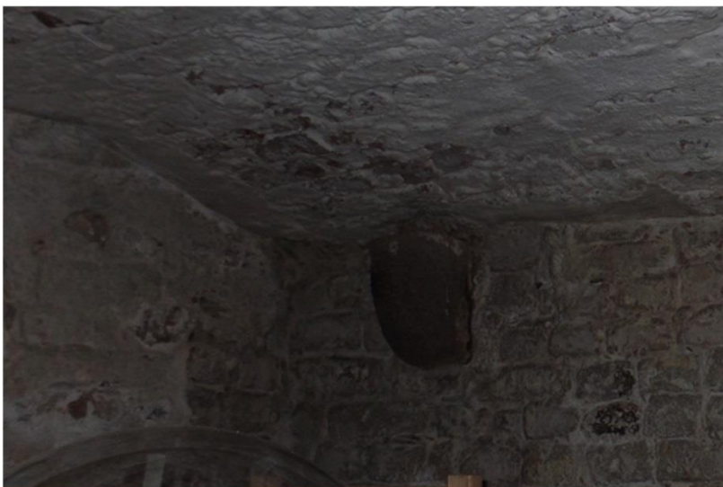
Deze draagsteen is een mogelijke aanwijzing dat de gewelfconstructie pas later is aangebracht
