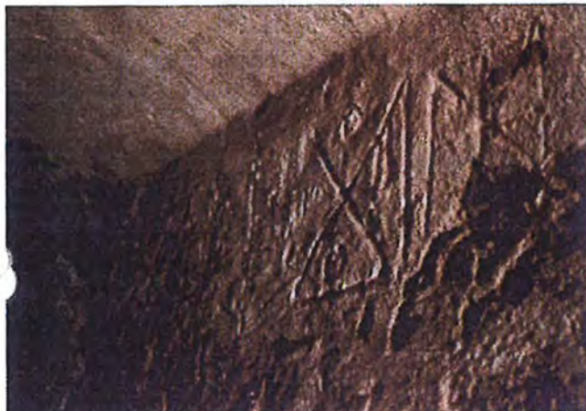
Krassen in wand achtergang; oude situatie
