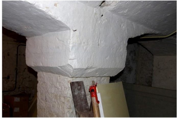
Troggewelven met een gordelboog steunend op twee van deze gemetselde zuilen met natuurstenen bovenzijde
